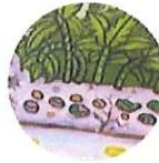
擋土牆龜裂、 擋土牆的排水孔堵塞
