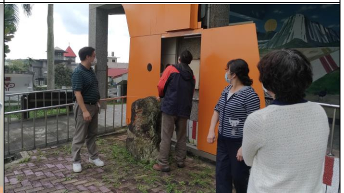
說明：王志豪委員了解變壓器裝置
